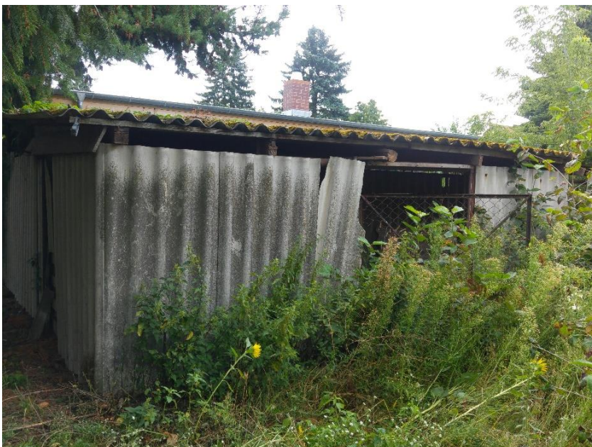
baufälliger Schuppen ca. 8 x 5 m, Asbest, auf Parz. 7
